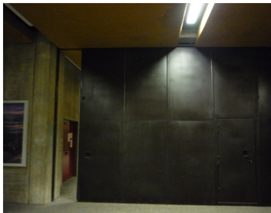
Rauchschutztor nahezu geschlossen
