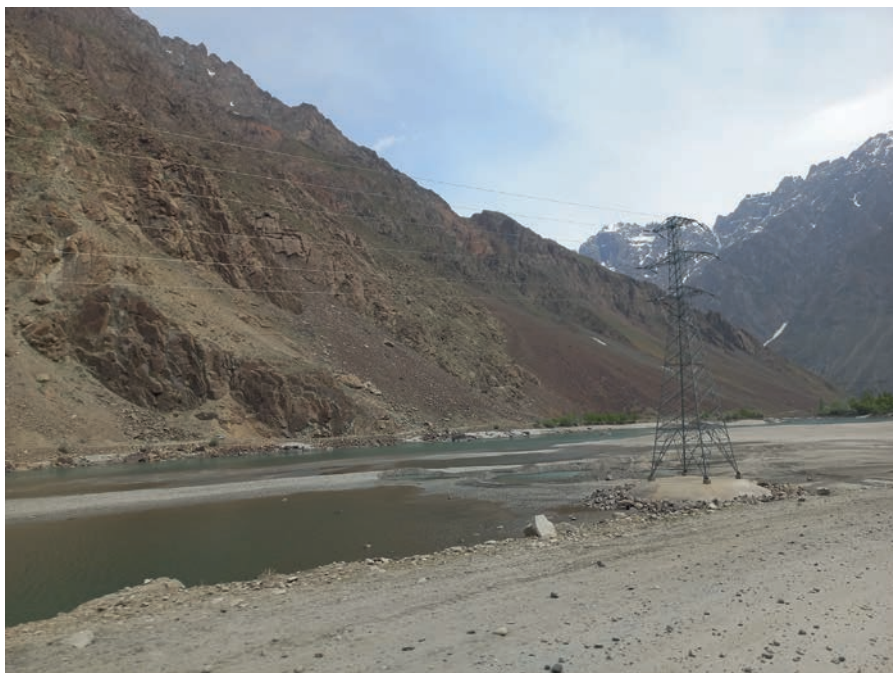
Fig. 28 — Lignes de transmission d'électricité construite par Pamir Energy entre le Tadjikistan (premier plan) et l'Afghanistan (arrière-plan), district de Shoughnon.
